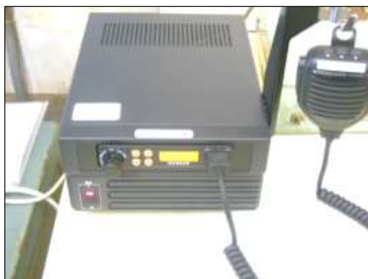
写真 ② 更新した無線機器
